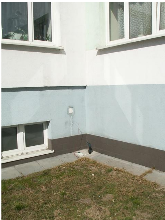
15) Blok 4 strona zachodnia, temp. Ściany 14C, ocieplenie styropianem 5 cm(zmierzone w otworze na kran) Uszkodzona izolacja Wynik \lambda=0,047 [W/(mK)]
