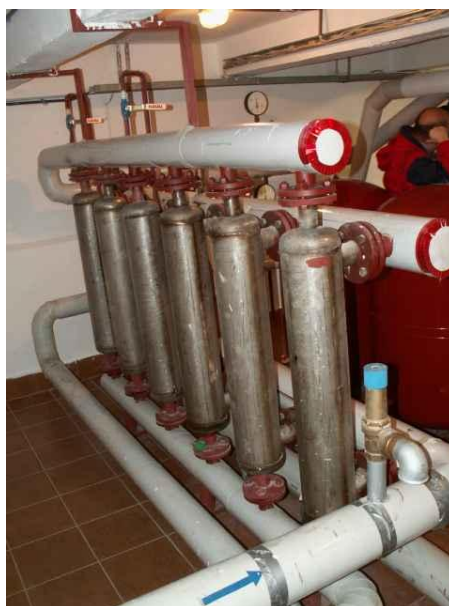
Rys.5. Wymiennik ciepła C.O. piwnica – strona prawa
