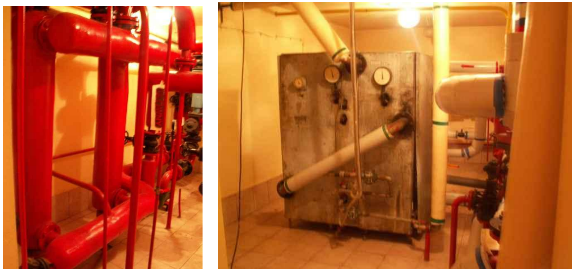
Rys.32. Wymienniki C.O. i C.W.U. (wraz ze zbiornikiem ciepłej wody)
