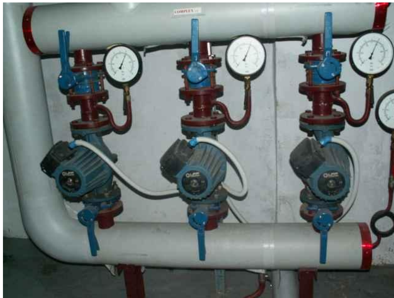
Rys.39. Zespół pomp cyrkulacyjnych C.O. na zasilaniu budynku
