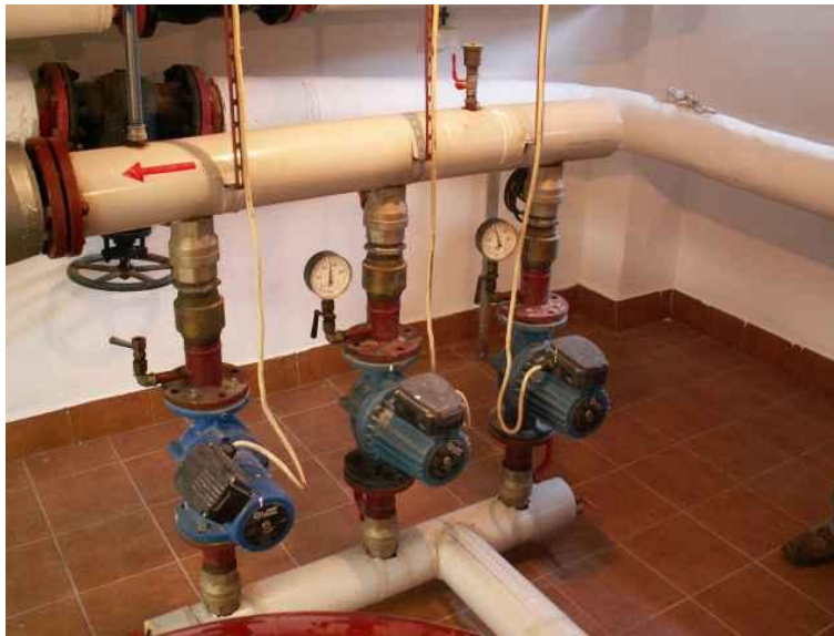
Rys.7. Zespół pomp cyrkulacyjnych C.O. na zasilaniu budynku
