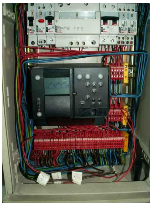
Rys. 9. Szafka z regulatorem pogodowym ECL 2000
