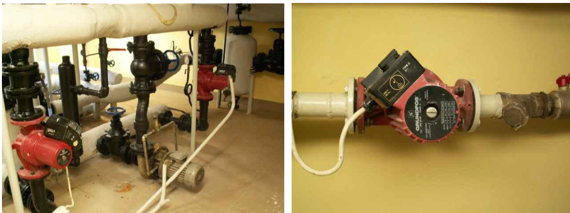
Rys.42. Zespół pomp na zasilaniu C.O. oraz pompa na powrocie C.W.U.
