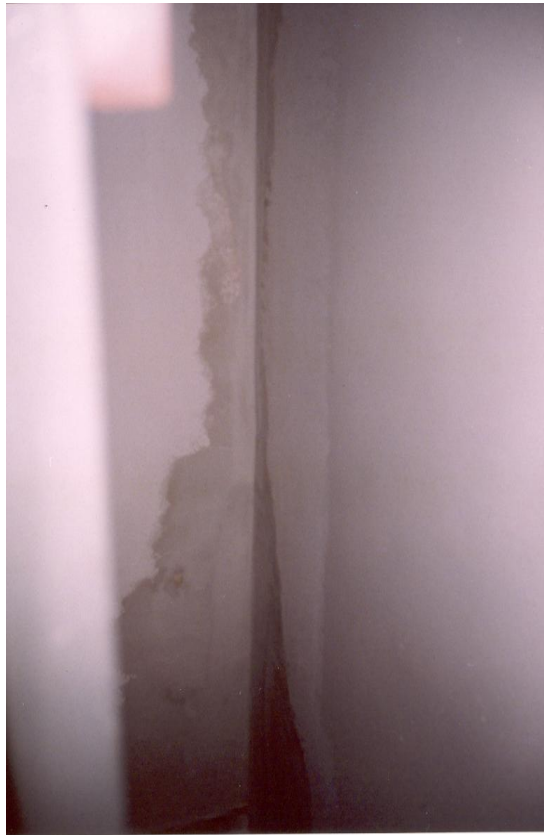
Rys.29. obraz naroża ścian w kilka dni po usunięciu grzyba -Pokój 417
