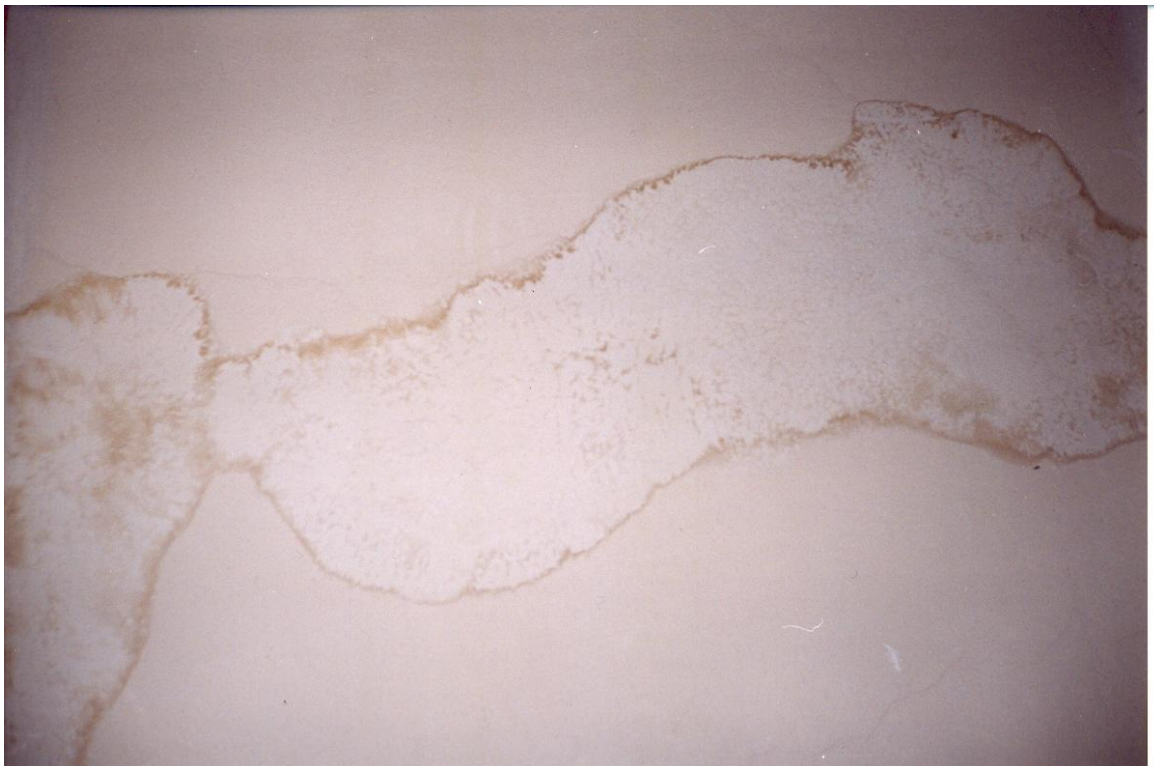
Rys.13. Obraz zawilgocenia powierzchni tej samej ściany. korytarza na wyższym poziomie- VIII piętro
