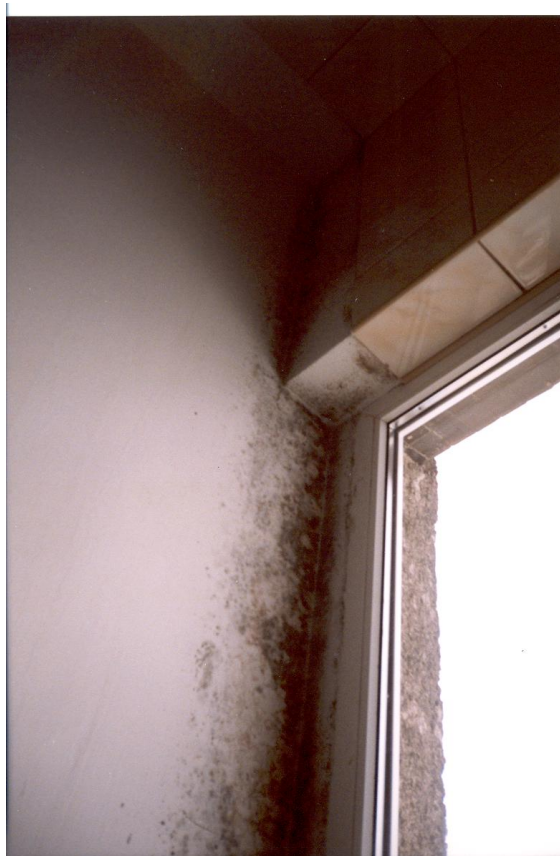
Rys.27.Zdjęcie zagrzybionego naroża w pobliżu futryny okiennej w łazience przy pokoju
