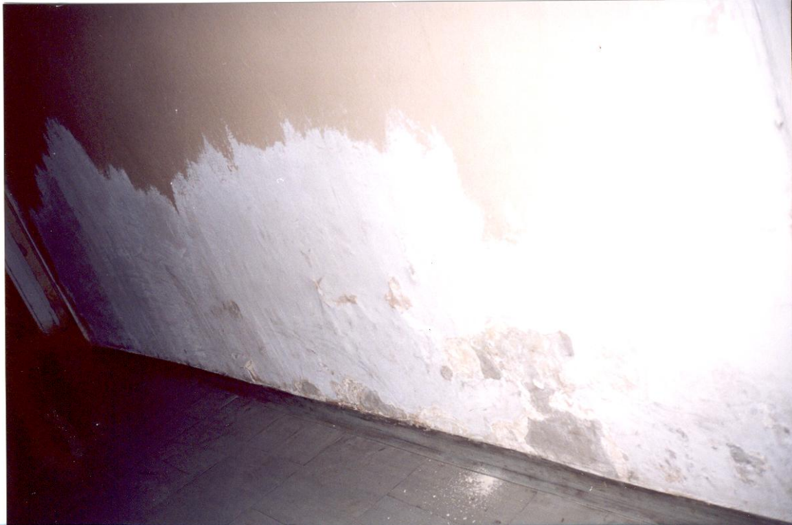
Rys.12. Obraz zmian powierzchni ścian korytarza na VIII piętrze przy podłodze.
