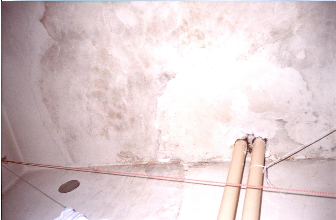
Rys.16. Obraz zawilgoconej powierzchni ściany w łazience przy pokoju 103, w której wykryto całkowity brak kratki wentylacyjnej.
