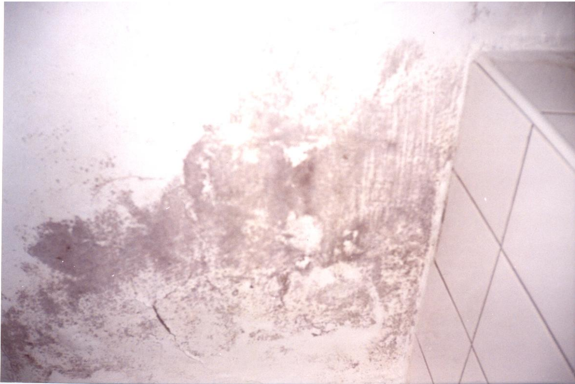
Rys.7.Zmieniona powierzchnia sufitu sanitariatu przy pokoju 310 i 311
