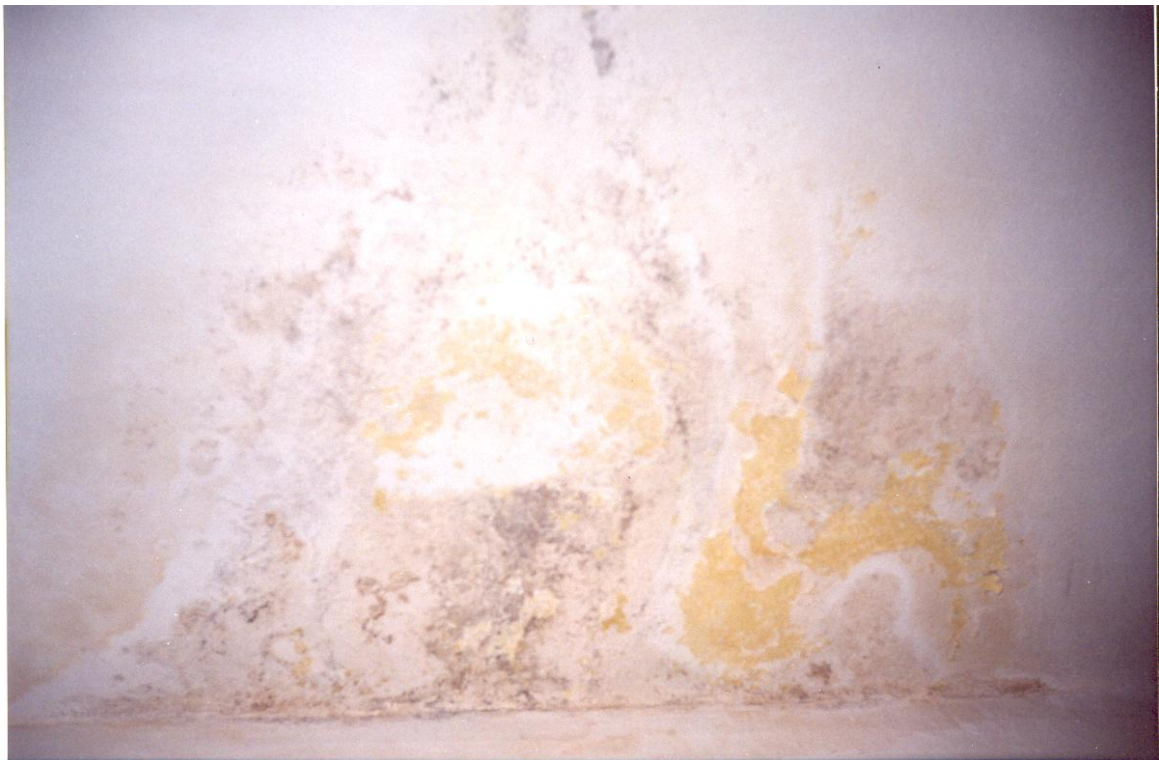
Rys. 8. Obraz zagrzybionej powierzchni ściany bocznej tego samego sanitariatu przy pokoju 310 i 311
