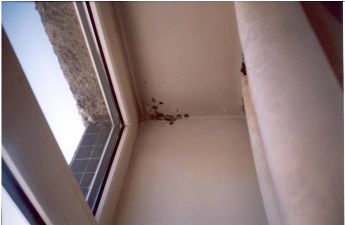
Rys.34.Zdjęcie sufitu z nalotem grzybowym w tym samym pokoju 403
