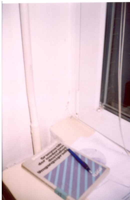
Rys.30. Zdjęcie rogu pokoju 402; w rogu okna widać początki nowego grzyba (dół)
