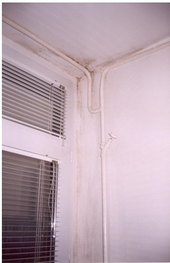
Rys.32.Zdjęcie drugiego, zawilgoconego i zagrzybionego rogu pokoju 403
