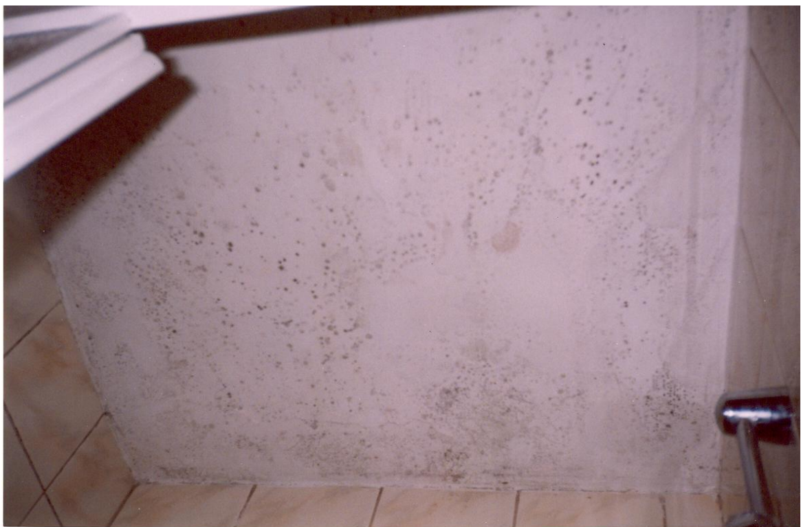
Rys.35.Zdjęcie zawilgoconej powierzchni ściany sanitariatu z widocznym nalotem pleśni przy pokoju 311.
