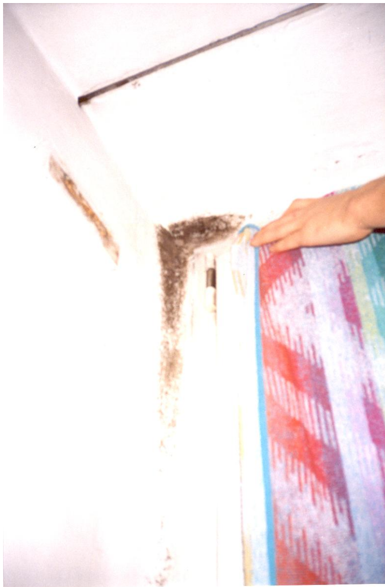
Rys. 2. Zdjęcie zagrzybionego naroża przy framudze okiennej -Pokój nr201
