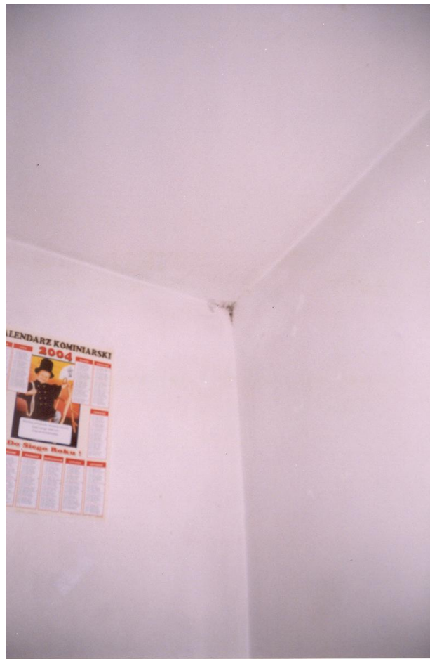
Rys. 26. Wykwit grzyba w narożu pokoju 115
