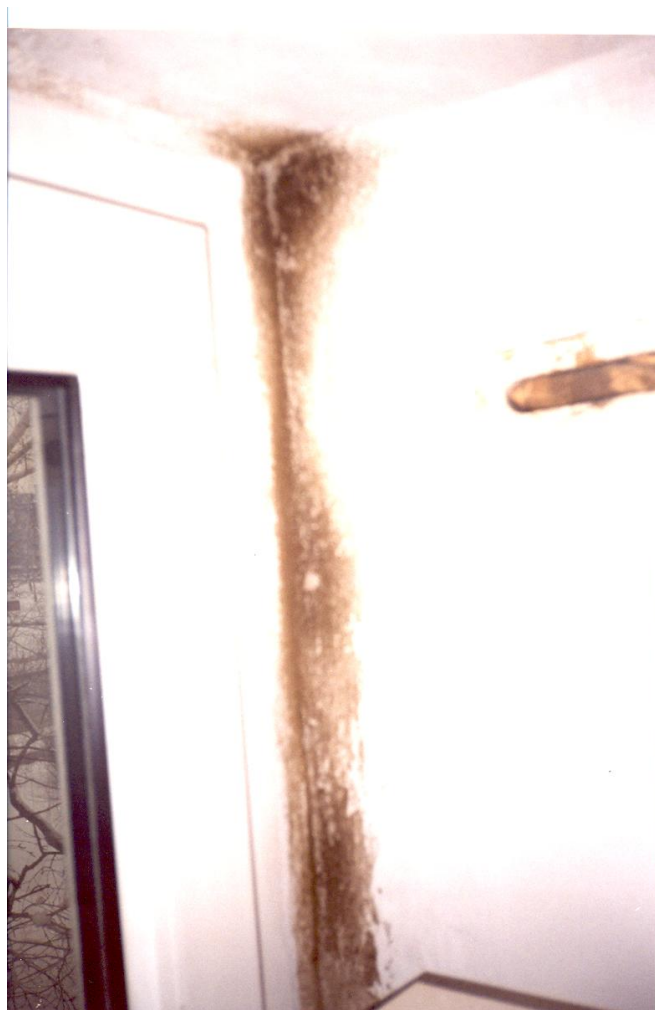
Rys.3 Zdjęcie zagrzybionej powierzchni ściany-. Pokój 201
