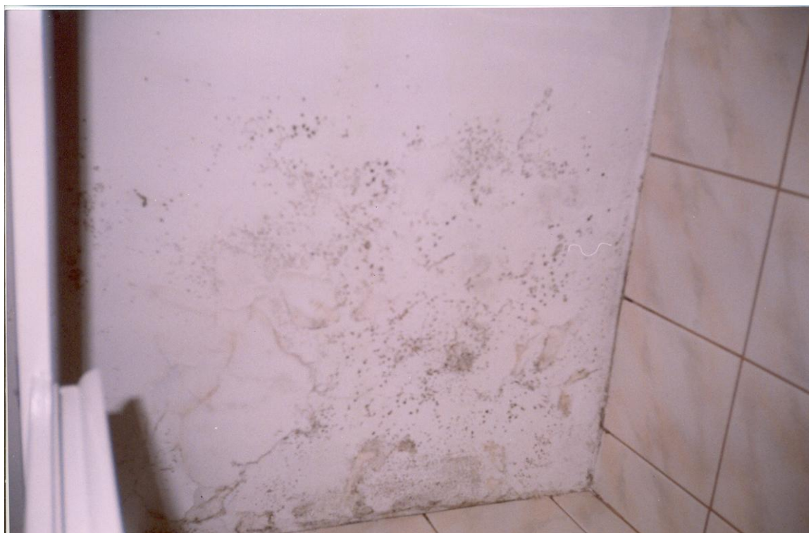
Rys.28. Zawilgocona powierzchnia ściany sanitariatu pokryta nalotem pleśni obok pokoju 216
