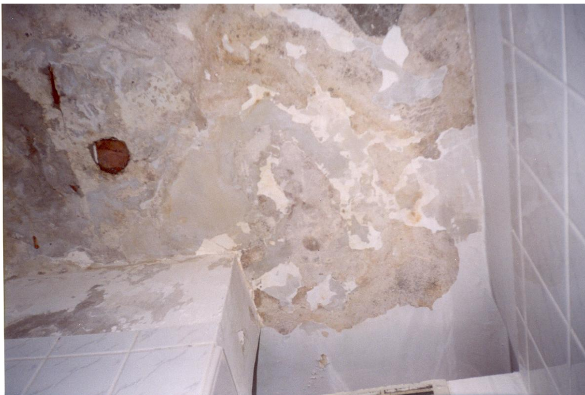
Rys.11.Kolejne zdjęcie zmienionej powierzchni. sufitu w łazience przy pokoju 811 a
