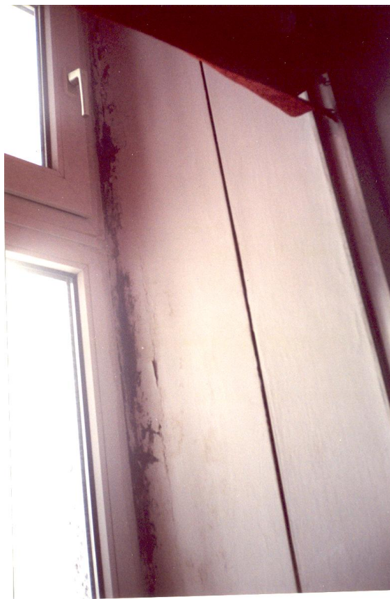
Rys.5 Kolejne zdjęcie zagrzybionej powierzchni ściany przy framudze okiennej-. Pokój 1507a
