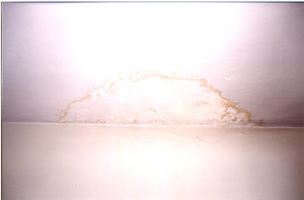
Rys.10. Obraz zawilgoconej powierzchni sufitu w łazience przy pokoju 811 a, w którym pomiary prędkości przepływu powietrza wentylacyjnego wykazały tzw. „zerową” wentylację.
