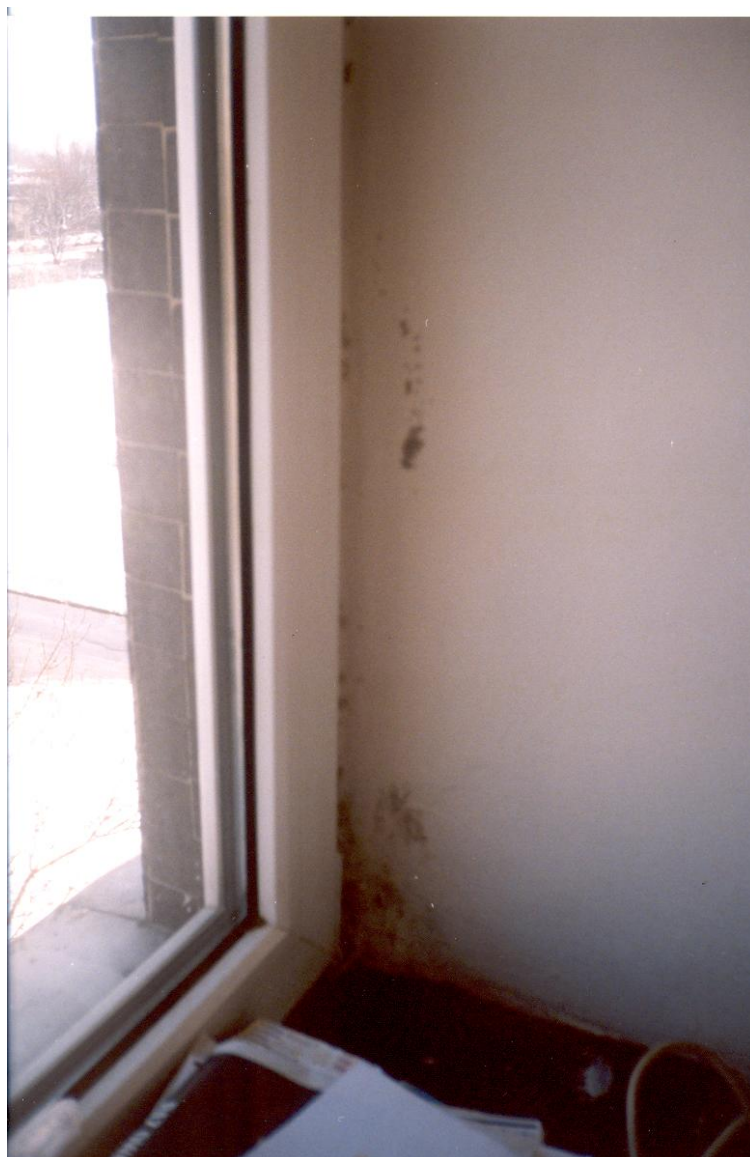
Rys.33 Zdjęcie grzyba w narożu przy futrynie okiennej pokoju 403
