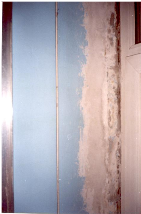
Rys.6 Zdjęcie zmienionej wykwitem grzybowym ściany przy framudze drzwi-. Pokój 1507
