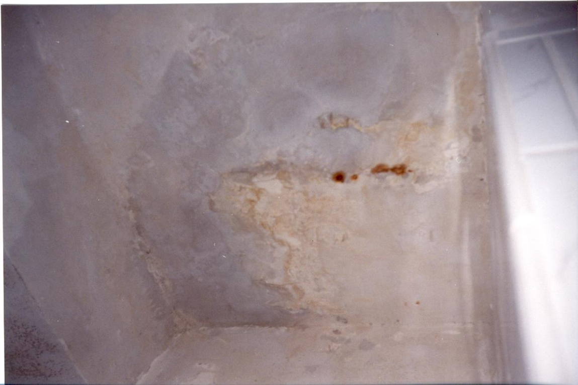
Rys.14. Obraz zmian na powierzchni ściany w łazience przy pokoju 200, w której kratka wentylacyjna została szczelnie zakryta folią
