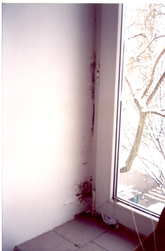
Rys. 20. Obraz zagrzybionej powierzchni- naroża w pobliżu stolarki okiennej okno w pokoju 318
