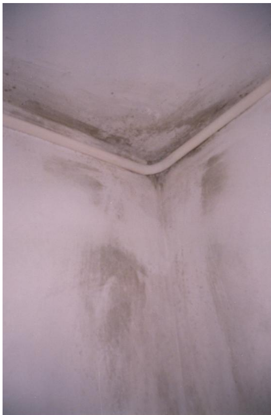
Rys. 31. Zdjęcie zawilgoconej powierzchni ścian i sufitu z widocznym nalotem grzybowym- Pokój 403
