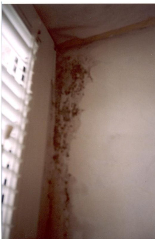
Rys.26.Zawilgocone naroże ściany w pobliżu stolarki okiennej- Pokój 302
